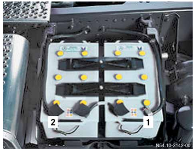
Batteriekasten (1) auf Fahrerseite (Geräteträger)
